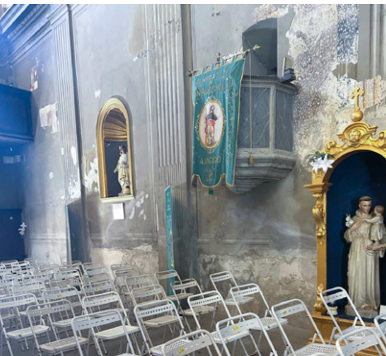
Été 2024: des chaises métalliques font office de bancs, le sol est recouvert de panneaux de contreplaqué.
